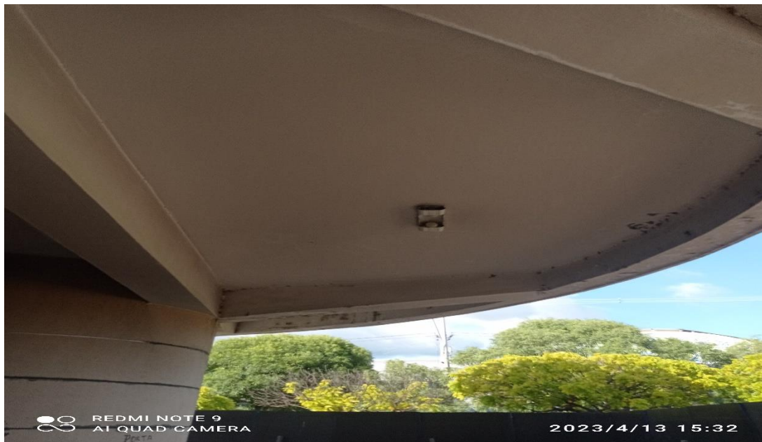
FOTO 05 – Infiltrações / Manchas na laje
