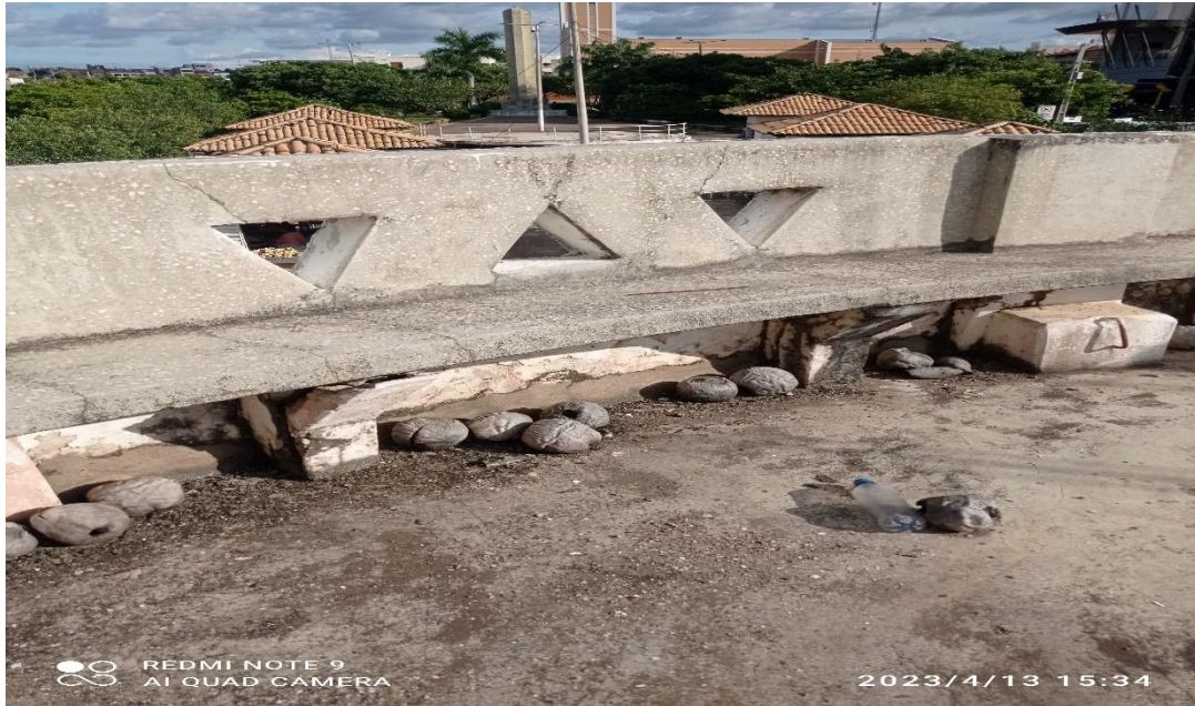
FOTO 08 – Fotos da Marquise / Piso
