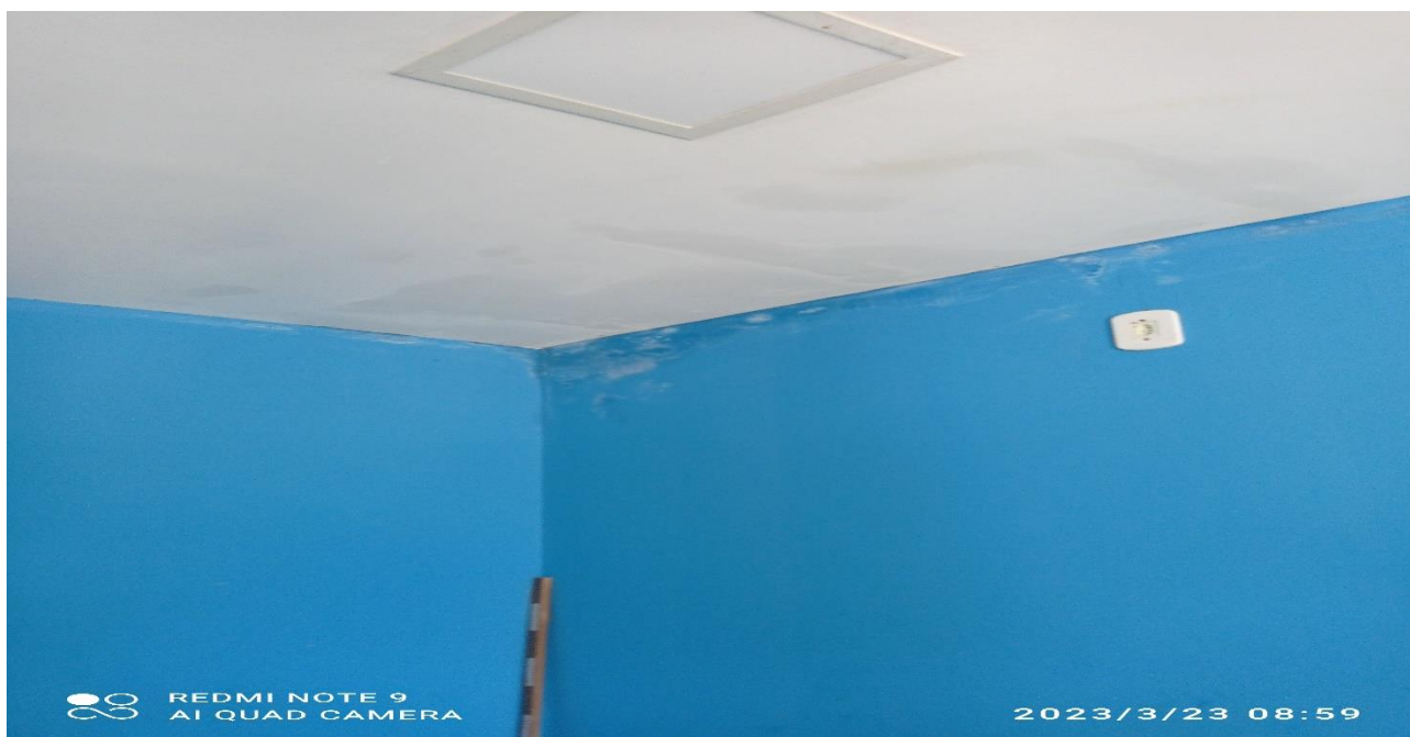
Foto 08– Infiltração na recepção
