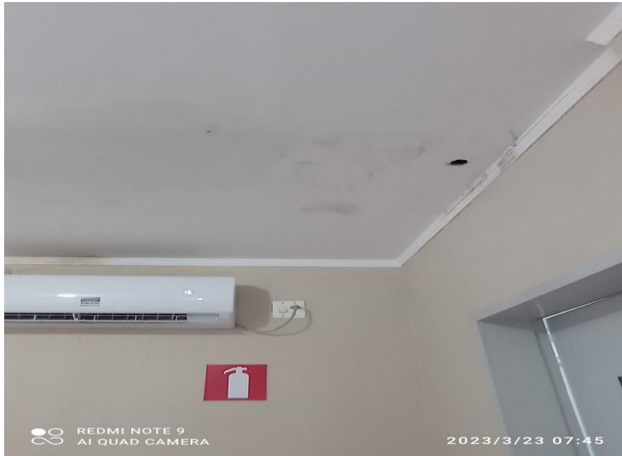
FOTO 05 – Infiltrações / Manchas no forro – consultório
