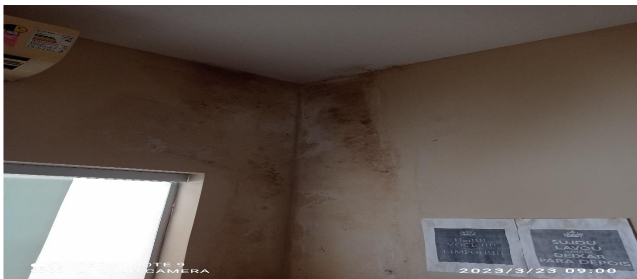
Foto 02: Infiltração na Sala médica
