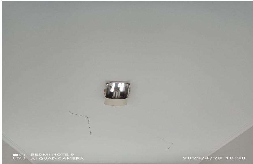
FOTO 11 – Luminárias sem uso.
