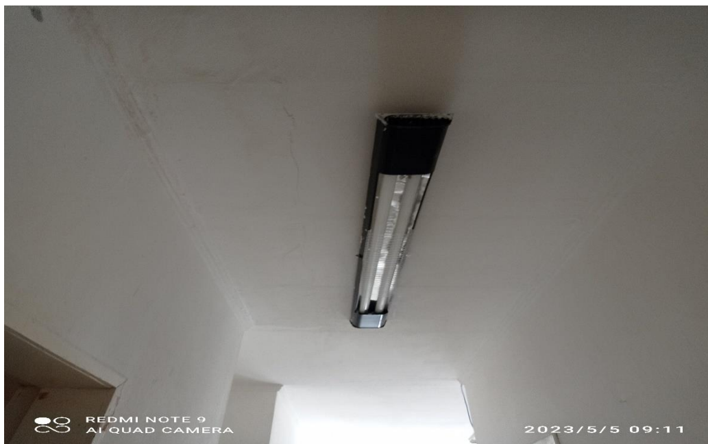
Foto 13 – Iluminação do Hall
