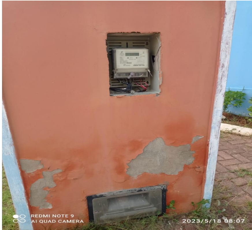
FOTO 09 – Quadro de Alimentação/ Entrada Principal
