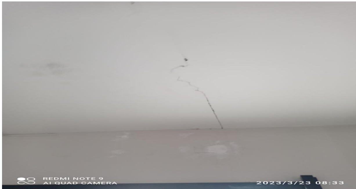
FOTO 05 – Infiltrações / Manchas no forro – consultório
