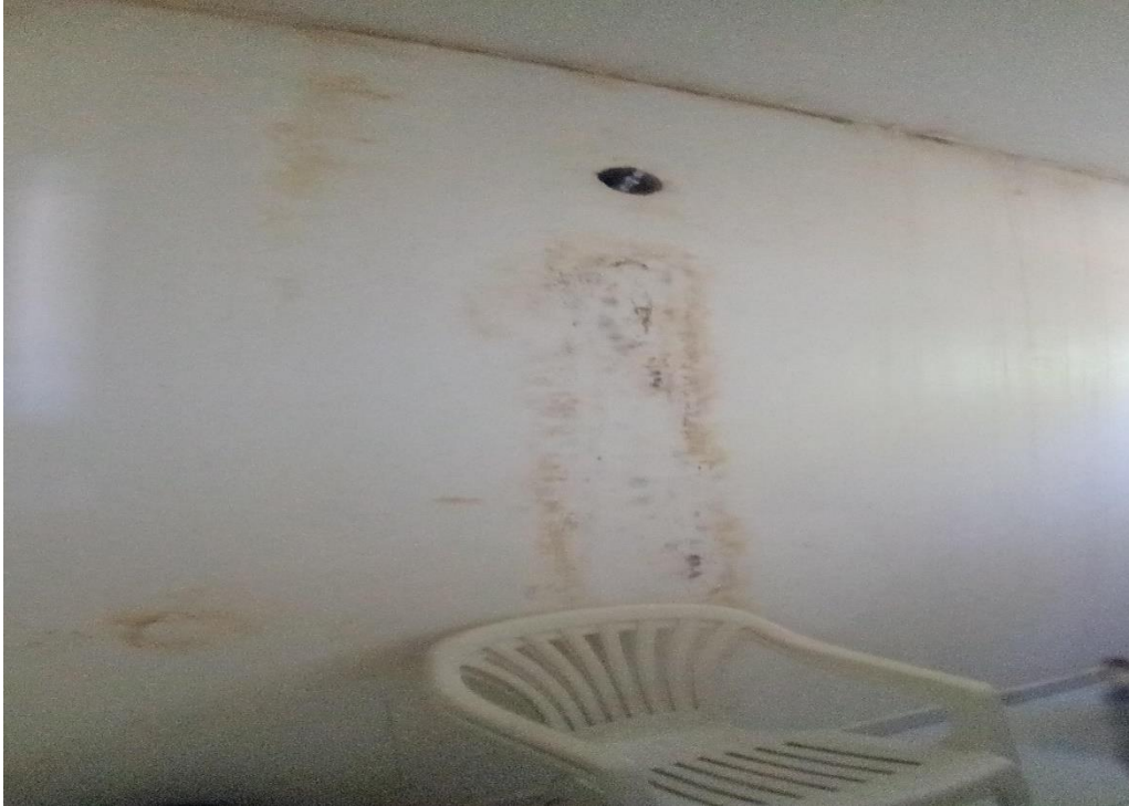
FOTO 17 - Infiltração causada por vazamento em reservatório
