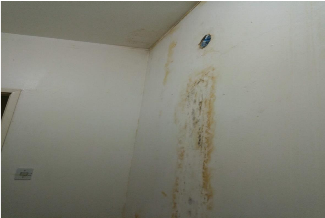
Foto 18 - Infiltração causada por vazamento em reservatório
