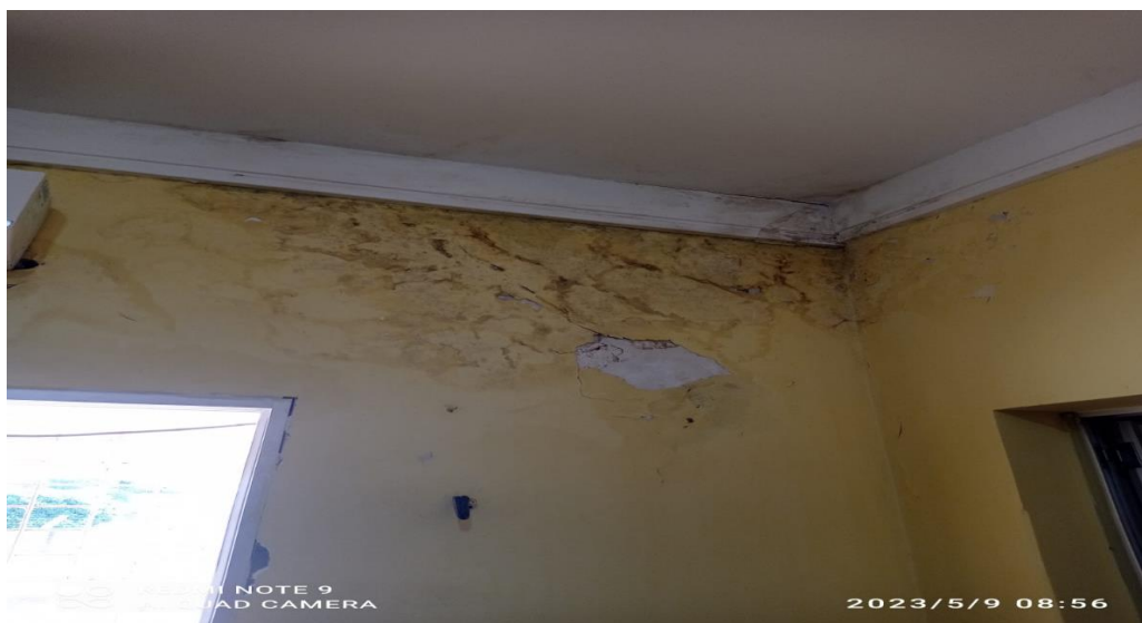
FOTO 08 – Infiltrações / Manchas no forro
