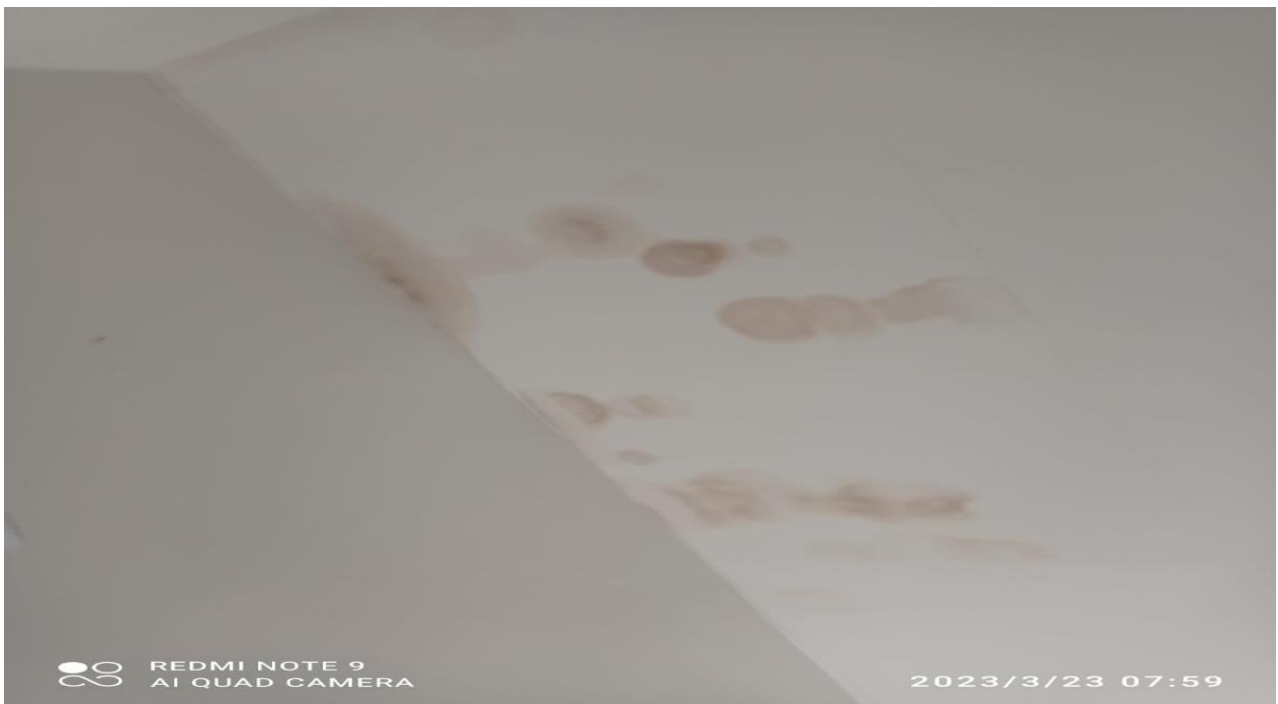
FOTO 05– Infiltrações / Manchas no forro – Recepção
