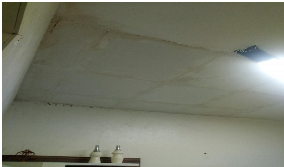
FOTO 16 – Infiltração causada por vazamento em reservatório
