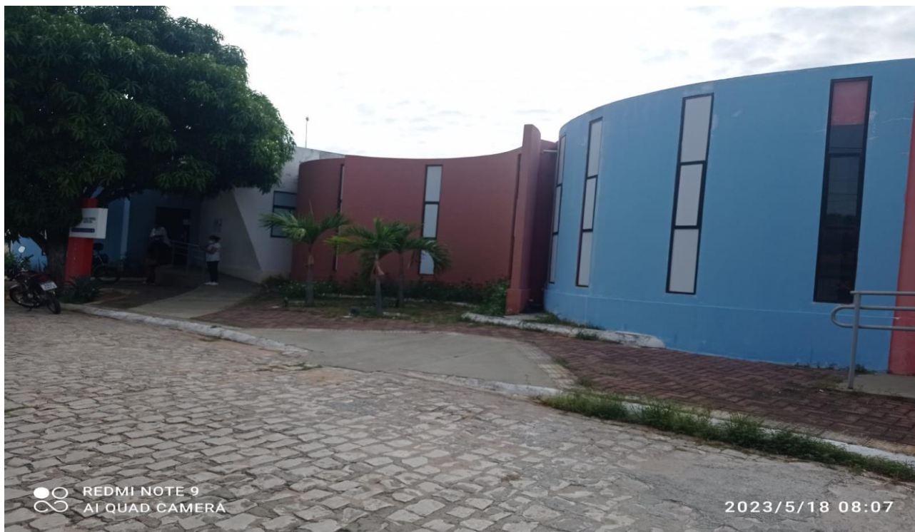
FOTO 07 – Infiltrações / Manchas em toda a fachada
