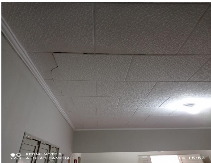
FOTO 03 – Fissuras em Forro
