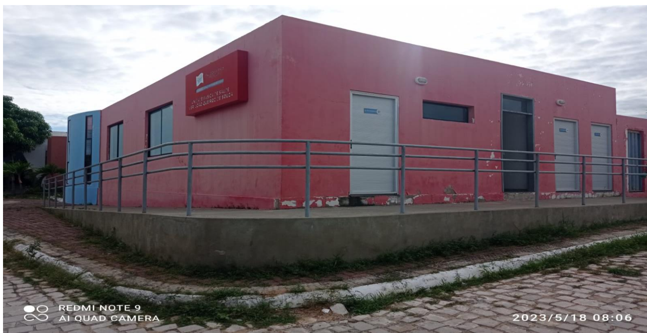
FOTO 08 – Infiltrações / Manchas em toda a fachada
