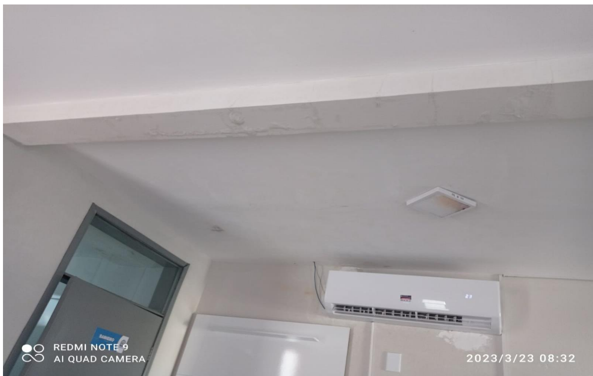
Foto 04 – Infiltração sobre Recepção
