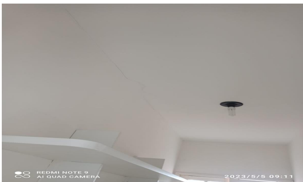
Foto 04 – Infiltrações em sala
