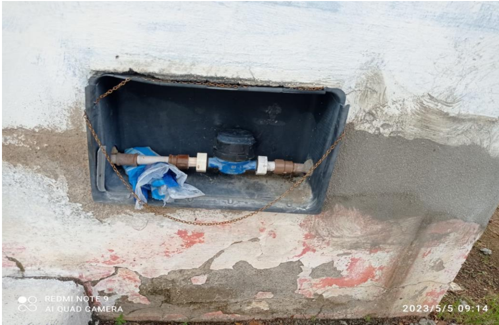
Foto 19 - Infiltração causada por vazamento em reservatório
