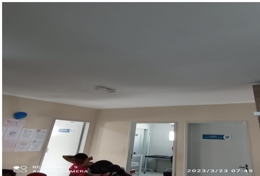
FOTO 12 – Ambientes sem Iluminação
