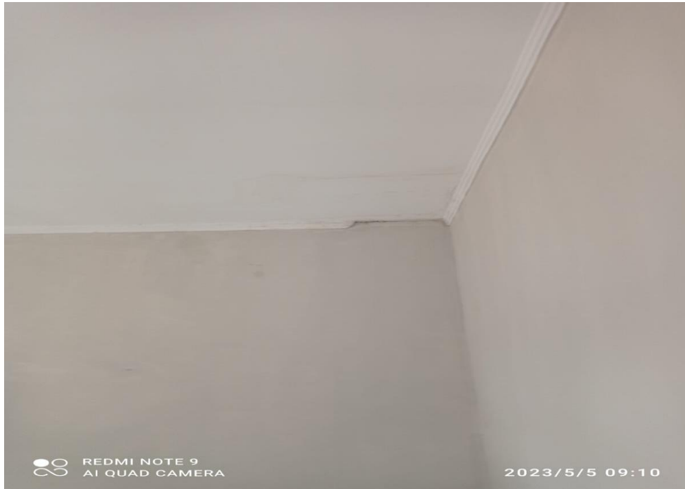
Foto 05 – Infiltrações em sala de Dentista
