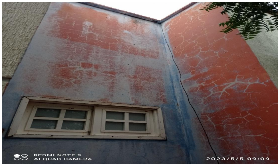
Foto 07 – Paredes Externas lado Esquerdo
