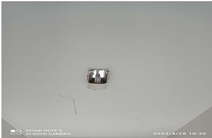
FOTO 11 – Luminárias sem uso.
