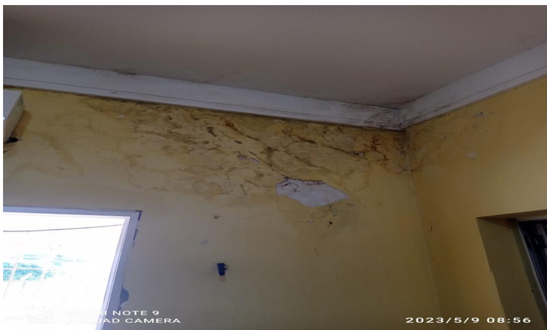
Foto 04: Infiltrações – Descanso dos enfermeiros
