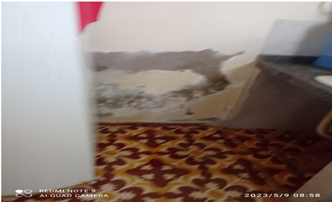
Foto 06 – infiltrações na cozinha
