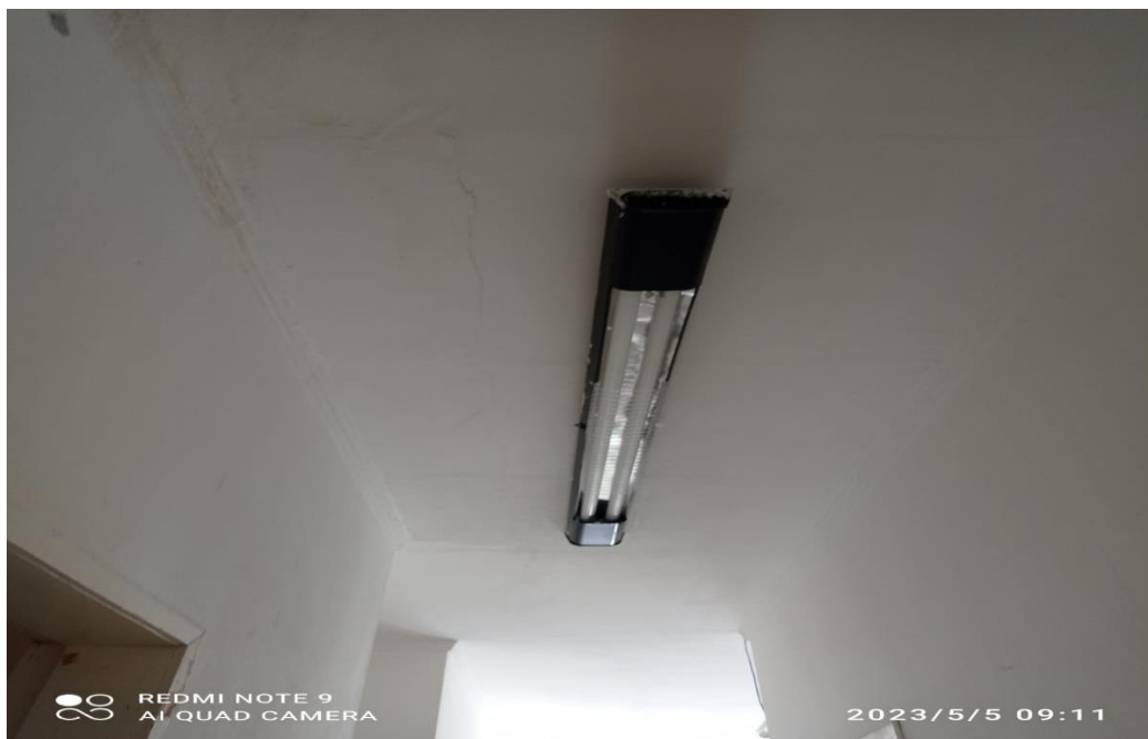
Foto 06 – Infiltrações em Hall/ Circulação
