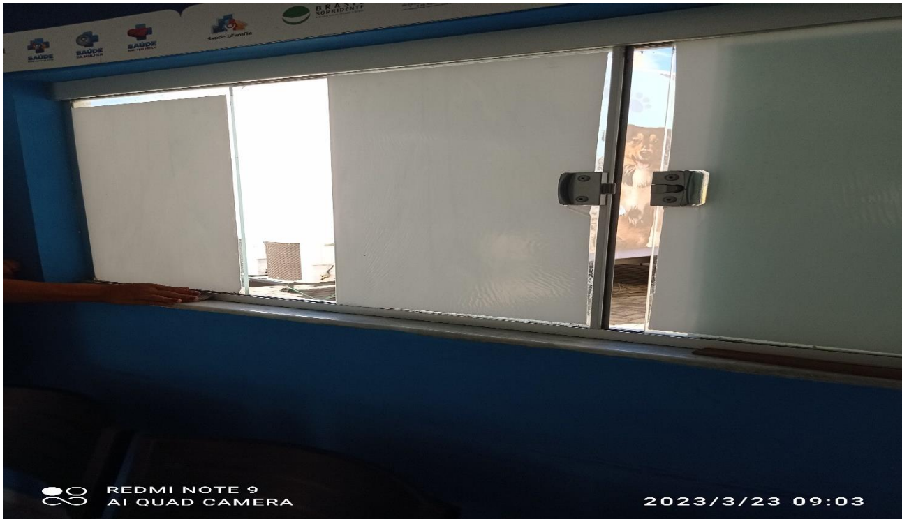
FOTO 13 – Janelas sem travamento
