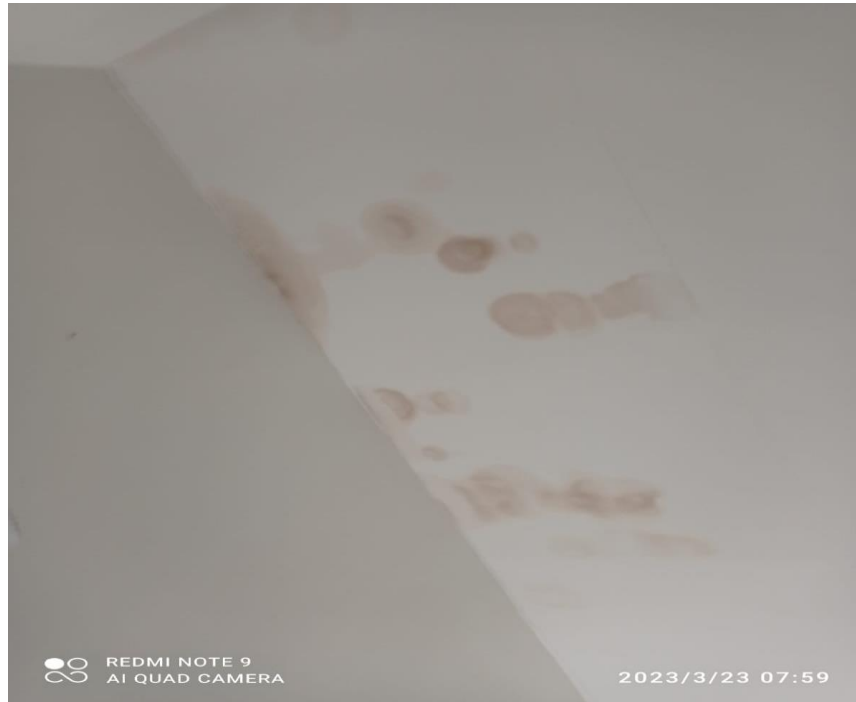
FOTO 07– Infiltrações / Manchas no forro – Recepção
