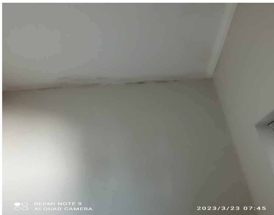
FOTO 06– Infiltrações / Manchas no forro – Recepção
