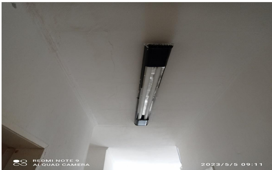
Foto 13 – Iluminação do Hall
