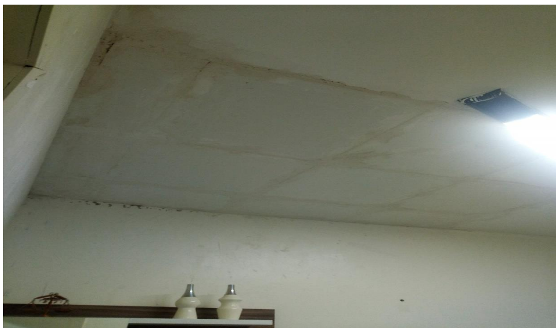
FOTO 16 – Infiltração causada por vazamento em reservatório
