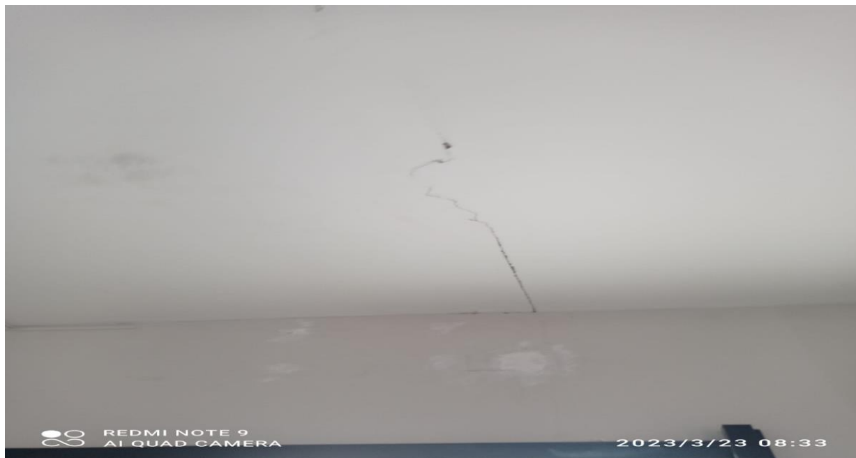
FOTO 05 – Infiltrações / Manchas no forro – consultório
