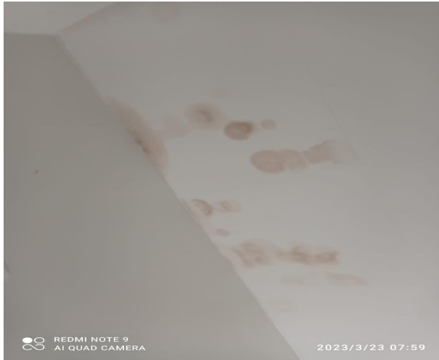
FOTO 07– Infiltrações / Manchas no forro – Recepção
