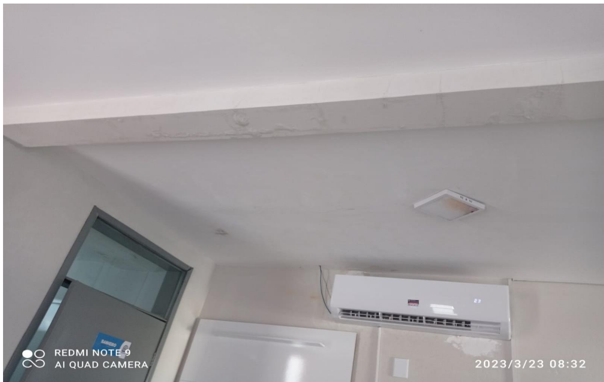
Foto 04 – Infiltração sobre Recepção
