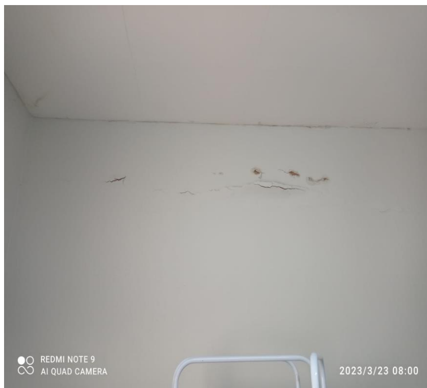
FOTO 08 - Infiltrações / Manchas no forro – Sala do médico
