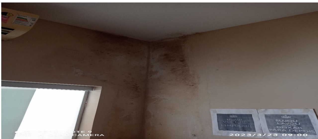
Foto 02: Infiltração na Sala médica
