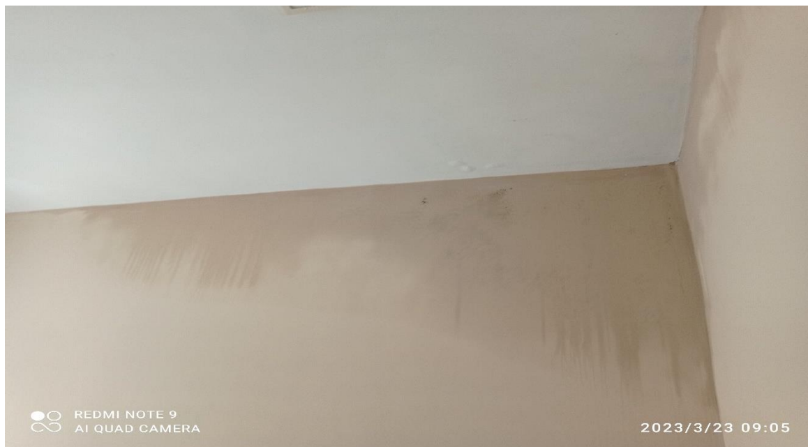
Foto 09 – Infiltração em Sala de Agentes
