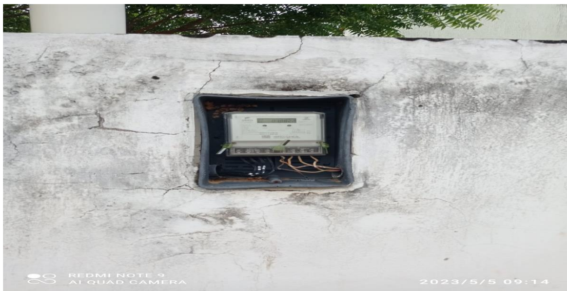
FOTO 15 – Quadro de entrada de energia
