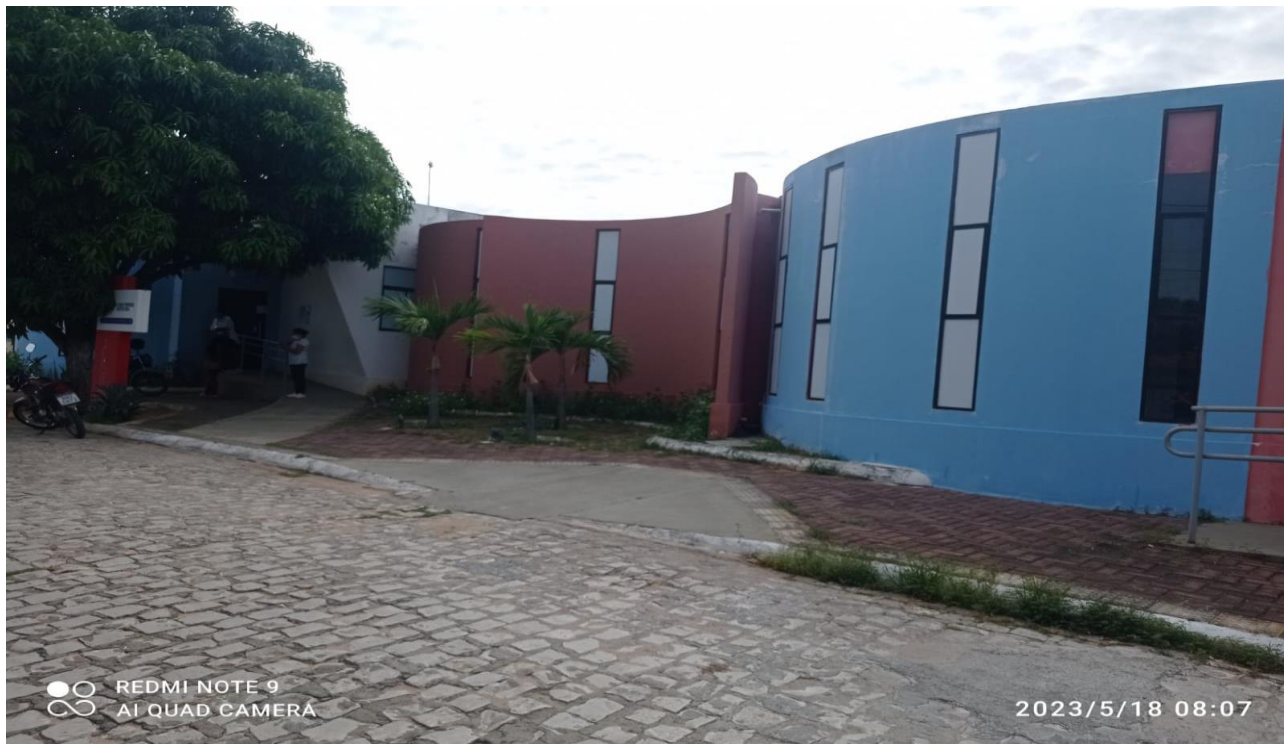
FOTO 07 – Infiltrações / Manchas em toda a fachada
