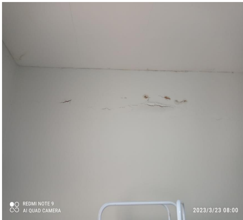
FOTO 08 - Infiltrações / Manchas no forro – Sala do médico
