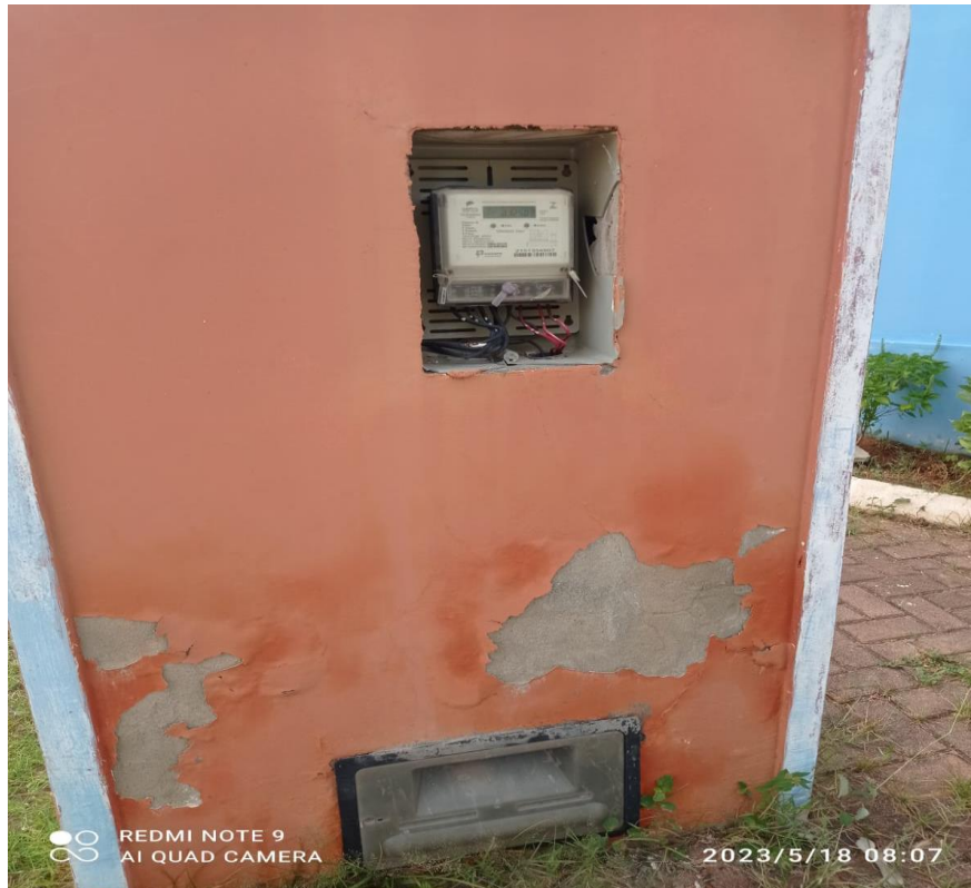
FOTO 09 – Quadro de Alimentação/ Entrada Principal
