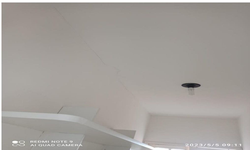
Foto 04 – Infiltrações em sala
