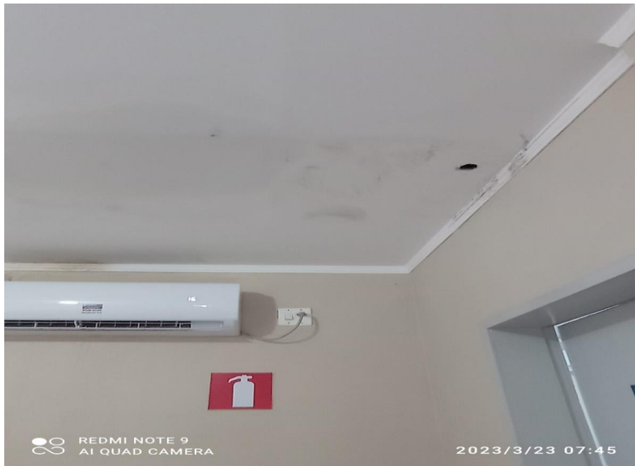
FOTO 05 – Infiltrações / Manchas no forro – consultório
