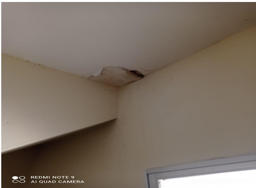
FOTO 07 – Infiltrações / Manchas no forro
