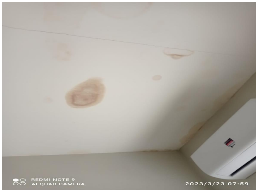
FOTO 06 – Infiltrações / Manchas no forro – consultório
