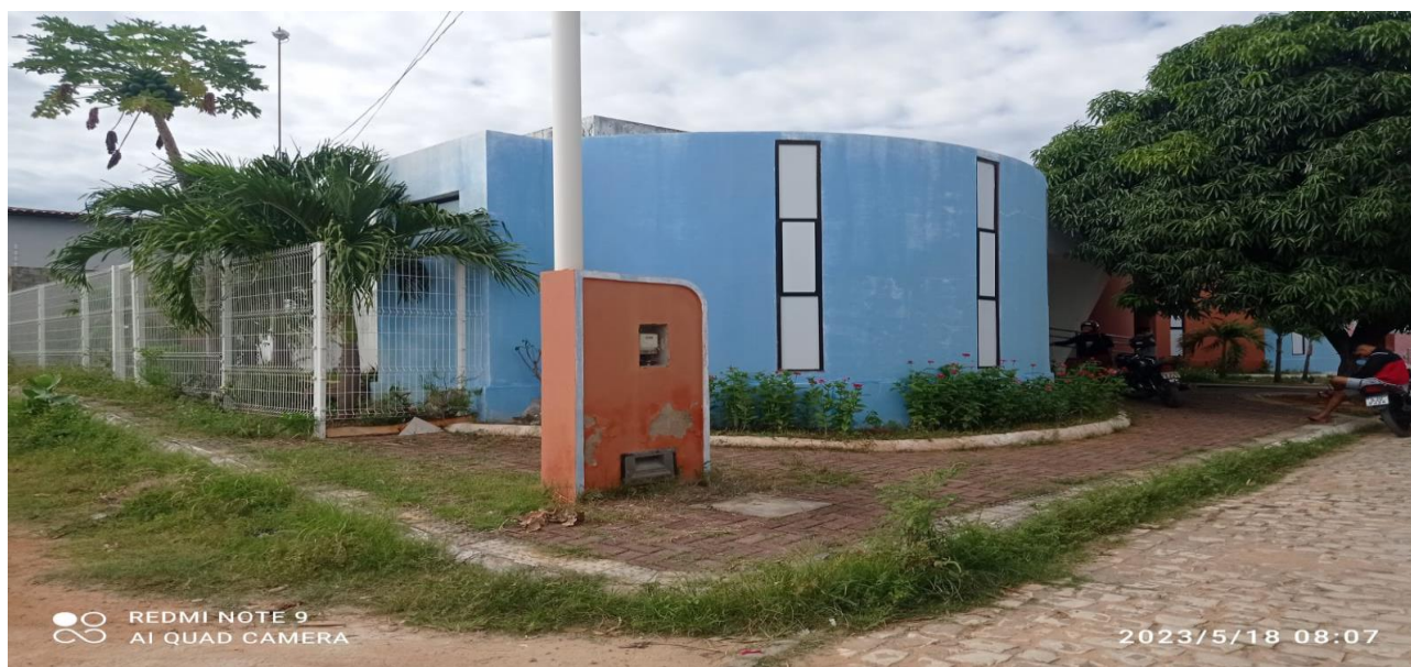
FOTO 06 – Infiltrações / Manchas em toda a fachada
