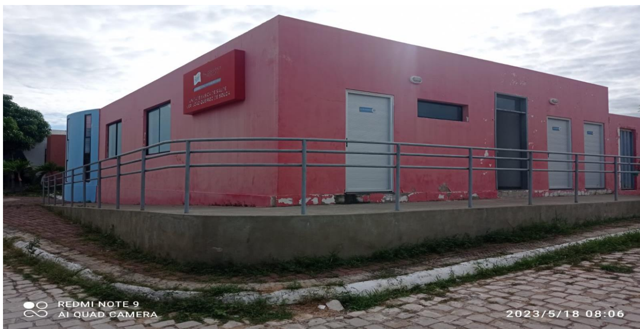
FOTO 08 – Infiltrações / Manchas em toda a fachada
