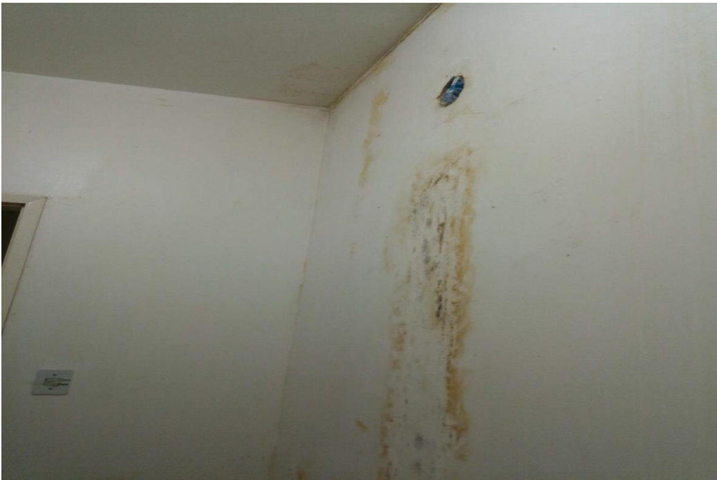
Foto 18 - Infiltração causada por vazamento em reservatório
