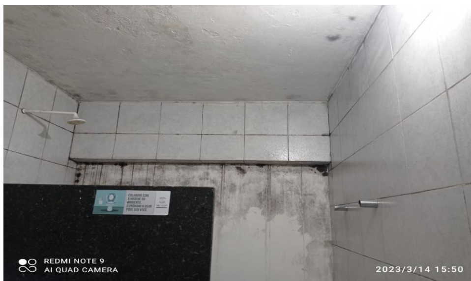
FOTO 02 – Infiltrações em Paredes
