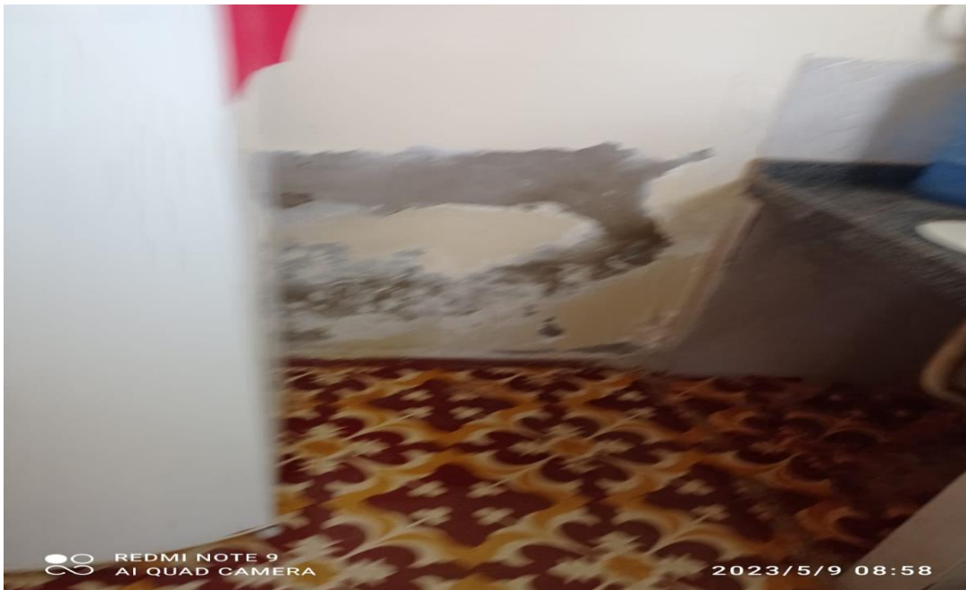
Foto 06 – infiltrações na cozinha
