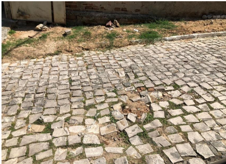
Foto 71: Buraco existente na rua Pedro Pierre dos Santos
