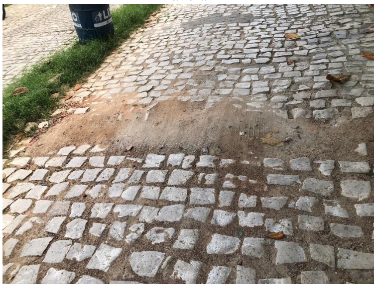
Fotos 123, 124, 125, 126, 127 e 128: Buracos existentes na Rua Carloto Fernandes Távora
