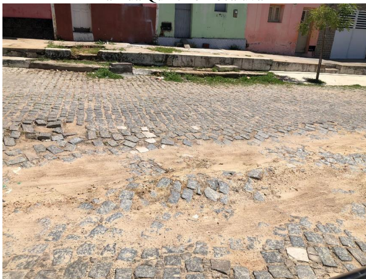
Fotos 73, 74, 75, 76, 77, 78, 79 e 80: Buracos existentes e meios-fios desintegrados na Rua Quintino Bocaiúva
