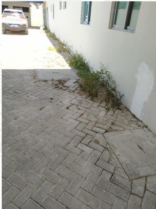
FOTO 28: Piso intertravado danificado
