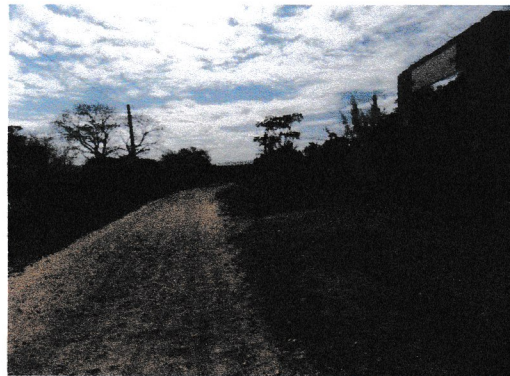
Final TRECHO Nº 03 - Continuação do Acesso Coordenadas UTM 590753 E e 9320716 S - Est 59
