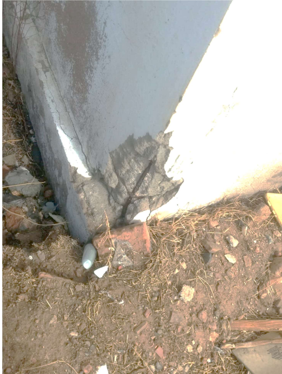
Figura 4: Desplacamento e fissuras.
