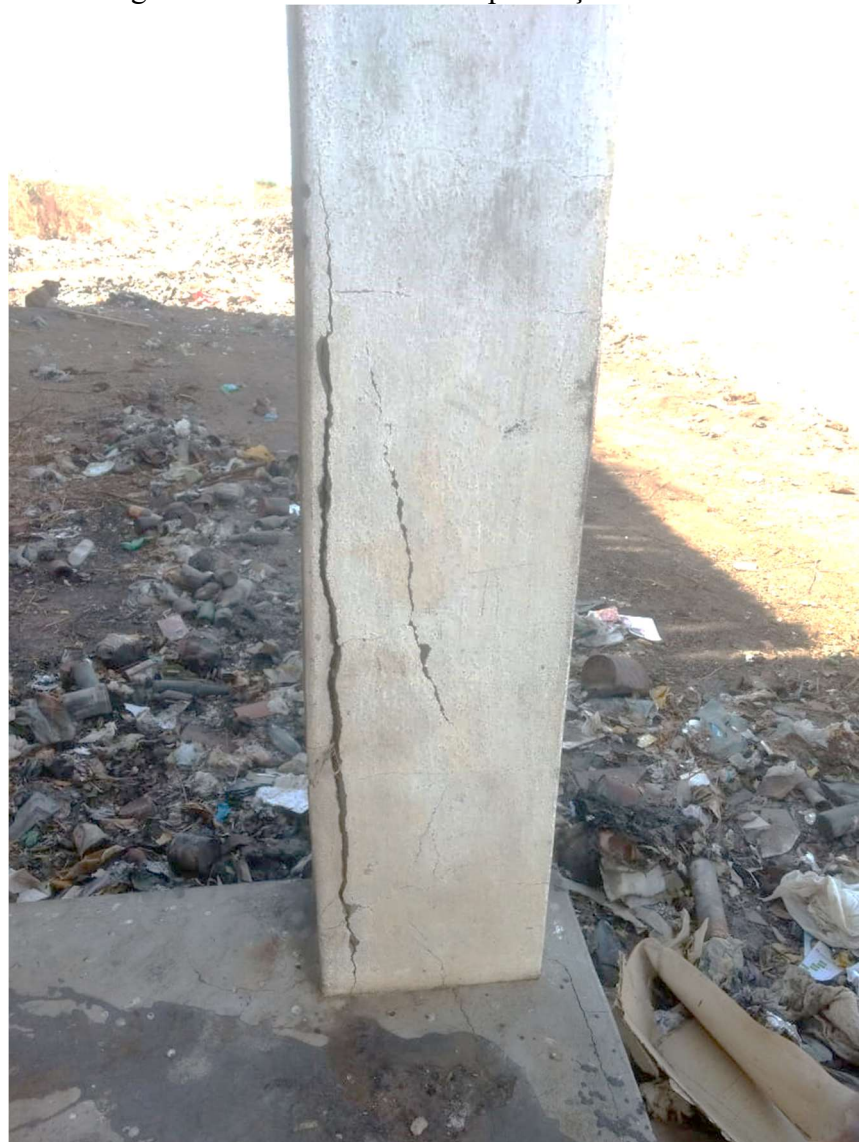
Figura 1: Pilar com fissuras e presença de lixo.
