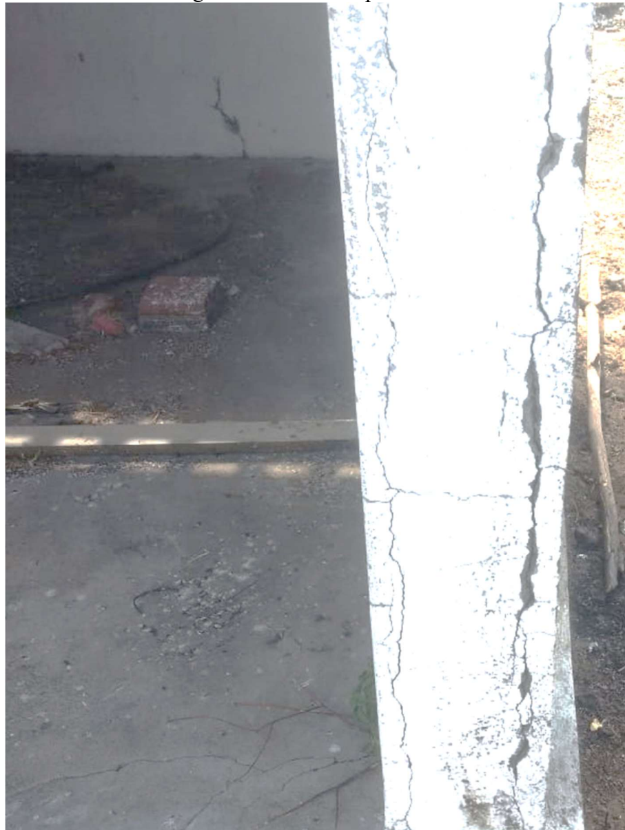
Figura 2: Fissuras no pilar.
