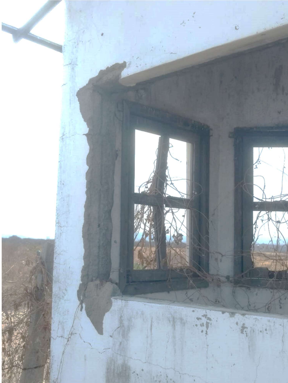
Figura 6: Desplacamento e fissuras.
