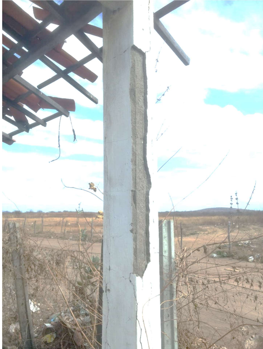
Figura 5: Desplacamento do pilar e telhas quebradas.
