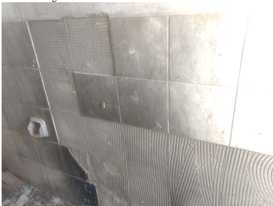
Figura 7: Revestimento cerâmico descolando.
