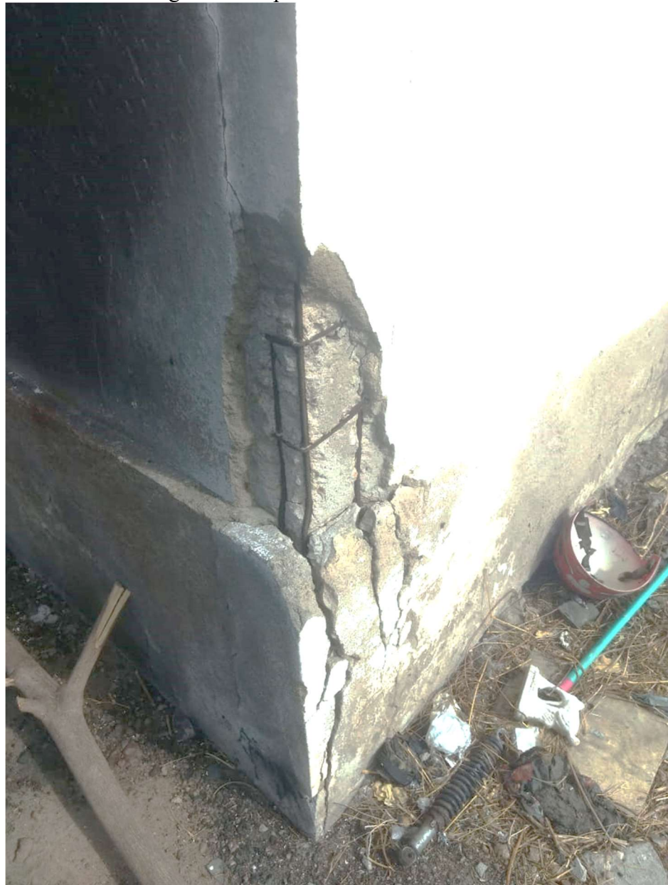
Figura 3: Desplacamento e fissuras.
